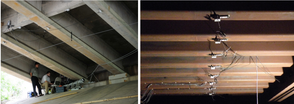
Figure 5 : Pesage sur pont à poutre (à gauche) et pont à dalle orthotrope (à droite).
